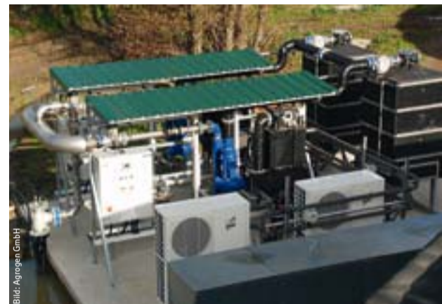
Zwei Aufbereitungsstationen entfeuchten und entschwefeln das Biogas, bevor es weitertransportiert wird
